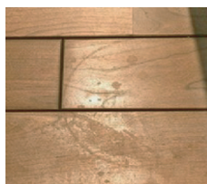
汚れや傷の部分
